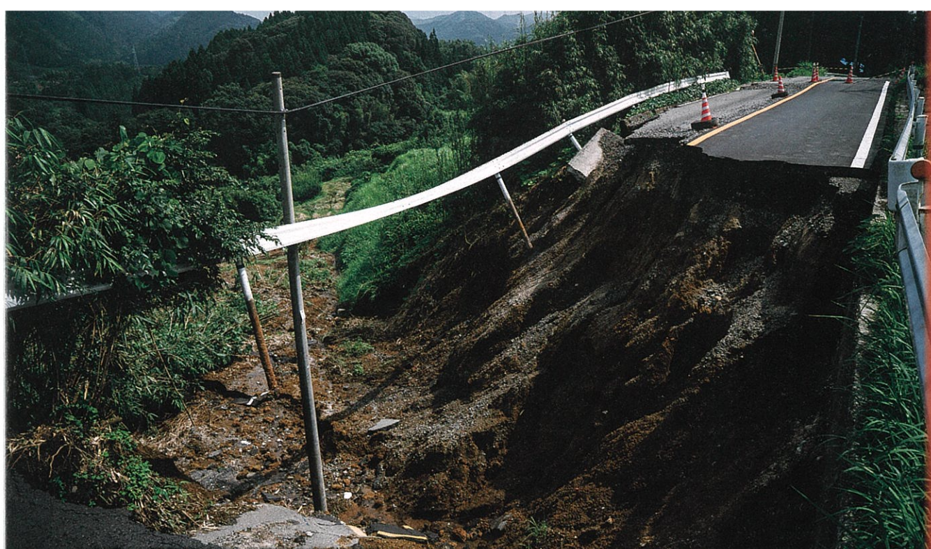
国道445号線(御船町 七滝東上野上地区) 震災後の大雨で完全に道路が寸断された。
